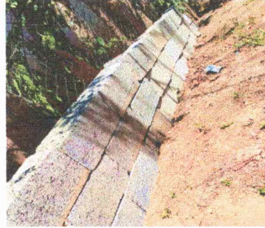
foto No.2 la pared se desprende por la falta de atension
